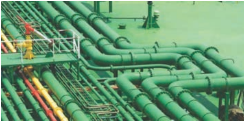
شکل ۲۹- سامانه لوله‌کشی روی عرشه یک نفتکش
