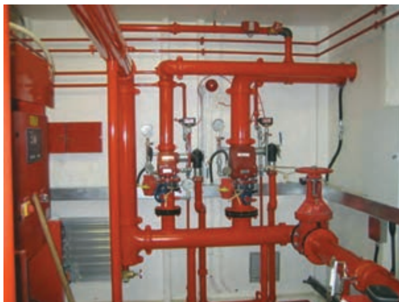
شکل ۱۰- قسمتی از سامانه آتش‌نشانی یک شناور
