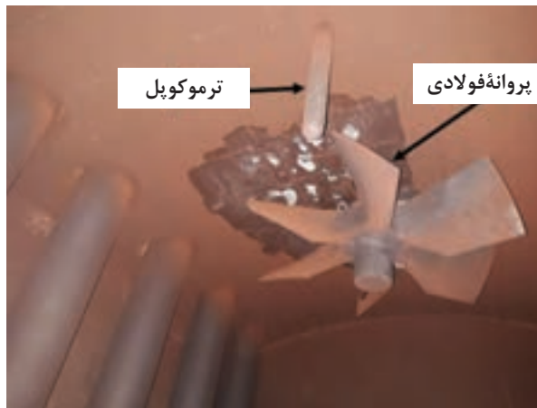
شکل ۱۸- فن گردش هوا در داخل کوره
