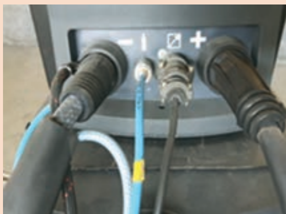
شکل ۹- کابل اتصال سوئیچی
