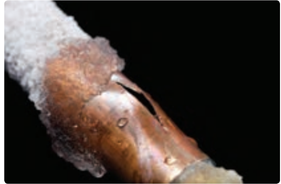
شکل ۶- شکستن لوله آب در اثر انجماد آب
