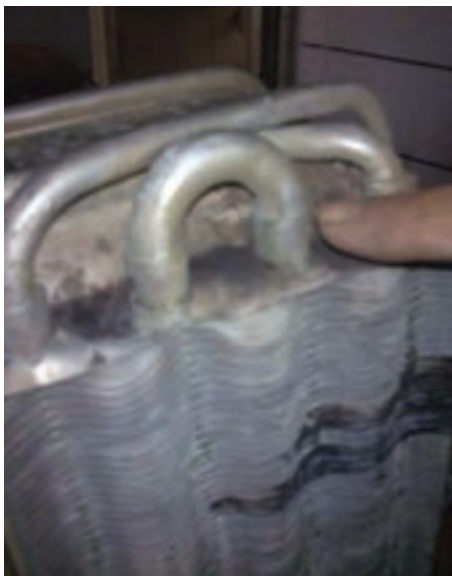
شکل ۱۱- تشکیل رسوب در آب گرم‌کن
