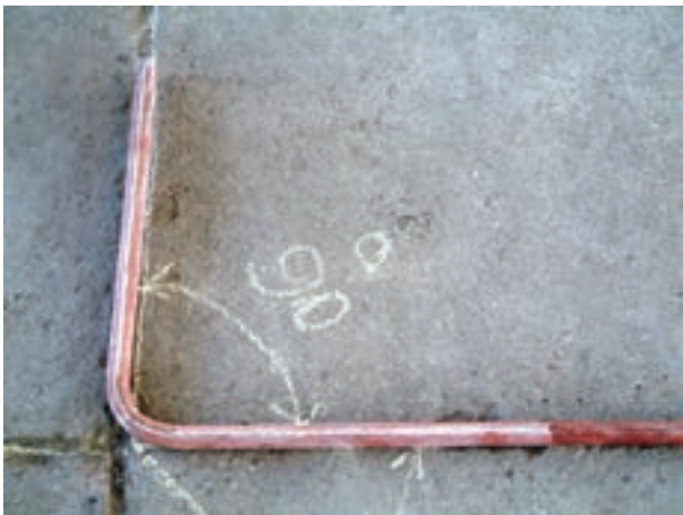
شکل ۳-۵۷- لوله‌ی خم کاری شده
