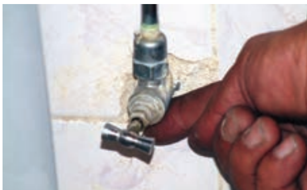
شکل ۱۴۷-۲- کنترل نشت آب از محل اتصال
