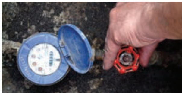
شکل ۱۴۵-۲- باز کردن شیر فلکه‌ی اصلی
