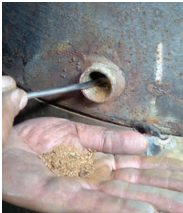
شکل ۱-۲۳- رسوبات جمع شده در کف مخزن آب گرمکن
