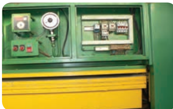
شکل ۸۴-۵: تابلوی فرعی برق نصب شده روی پرس
