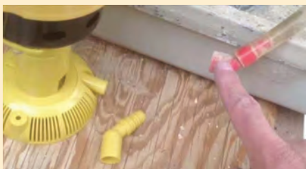
اتصال شیلنگ آب پخش کن به پمپ
