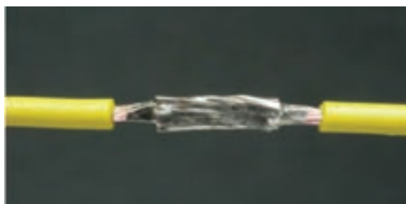
شکل ۱-۵۵- اتصال لحیم کاری کامل است.
