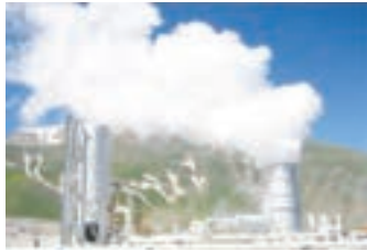
شکل ۱۲- نیروگاه زمین گرمایی مشکین شهر که با توان تولیدی ۱۰۰ مگاوات نصب شده است.
