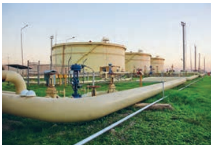
شکل ۲۱- نمایی از خطوط انتقال سوخت
