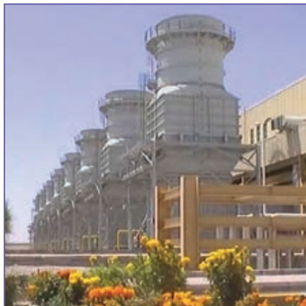
شکل ۶-۶- نیروگاه سیکل ترکیبی کرمان
