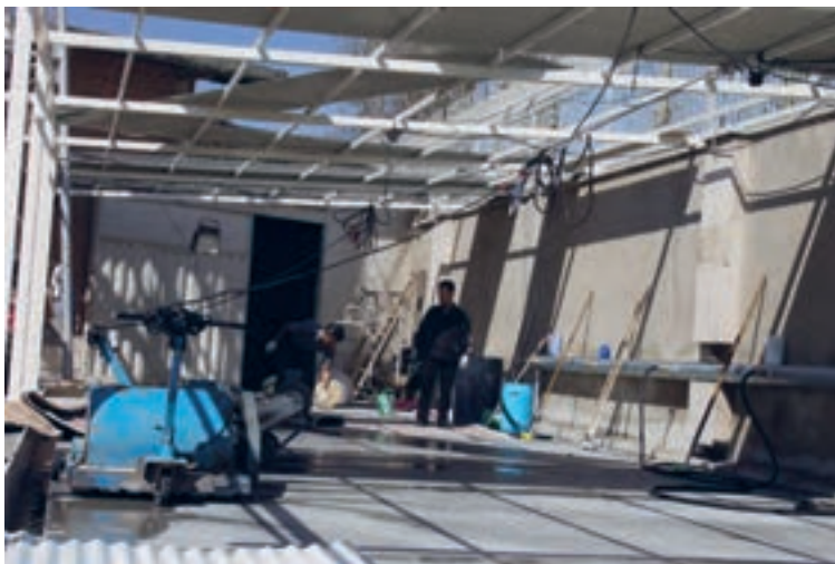
تصویر ۵- سالن شور در فضای بیرونی کارخانه ▲
