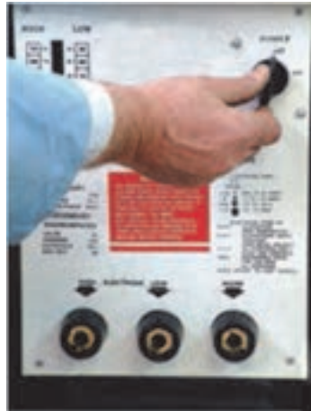
شکل ۵- نمایی از ترانسفورماتور
