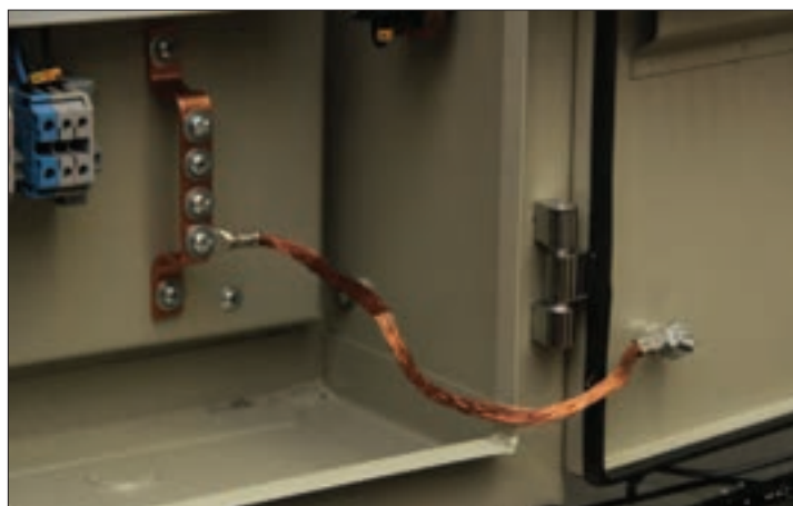
شکل ۹۲- صفحه نصب در داخل تابلو
