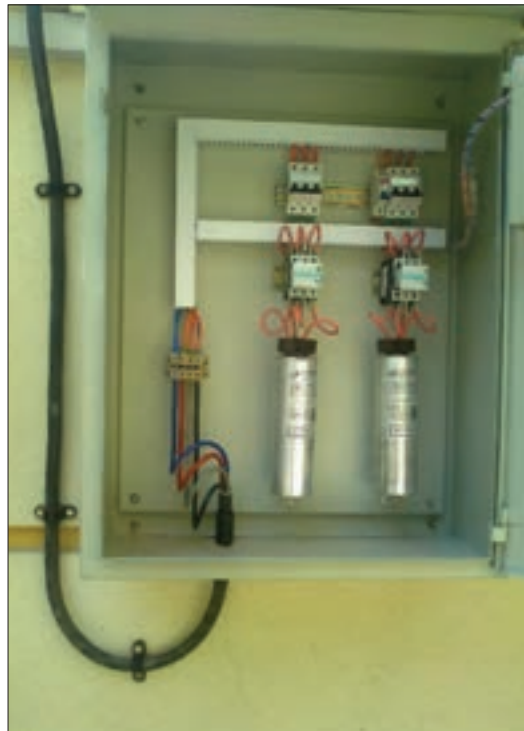
شکل ۲- تابلو بانک خازنی
