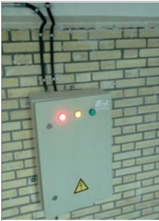
شکل ۲۰- مسیر ورود و خروج کابل‌ها در تابلو
