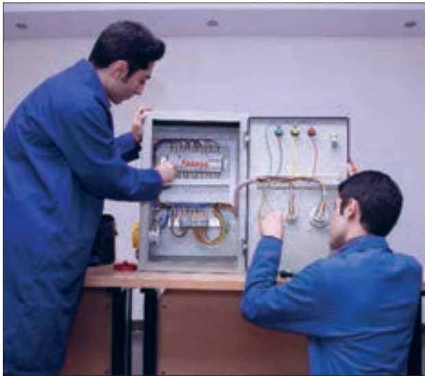
شکل ۲- تابلو برق فشار ضعیف
