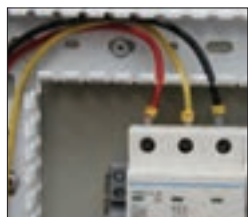
نصب غلط شماره سیم
