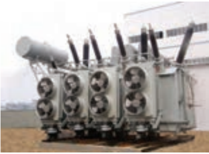
شکل (۳-۱) ترانسفورماتور خطوط انتقال
