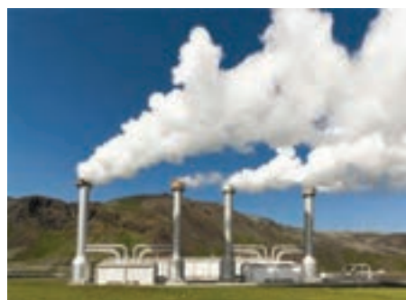
شکل ۱۱-۶- نیروگاه زمین گرمایی مشکین شهر - اردبیل
