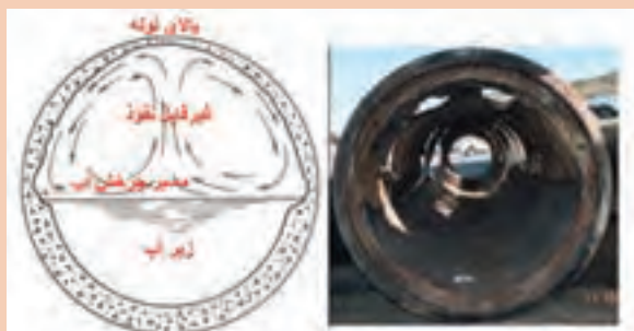
خوردگی در خط لوله آب
