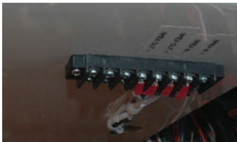
ترمینال اتصال کابل‌های VHF به GPS
