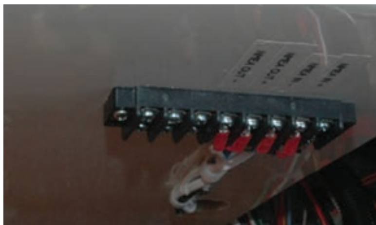
ترمینال اتصال کابل‌های VHF به GPS
