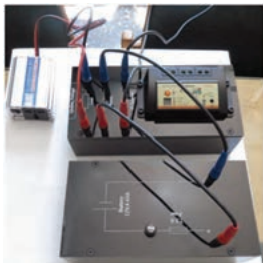
شکل ۱۴- اتصال باتری به کنترل شارژ
