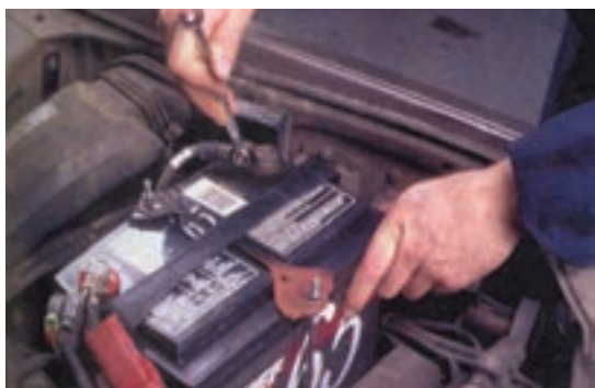
شکل ۱-۹۵- اتصال کابل‌های مثبت و منفی باتری
