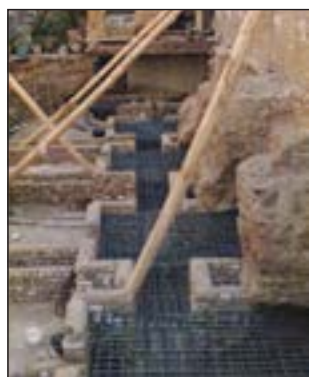
شکل ۹۰-۱ مهاربندی با شمع چوبی
