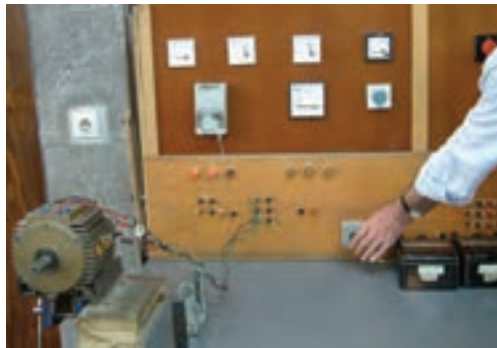
شکل ۹-۶- اتصال موتور به تابلوی برق
