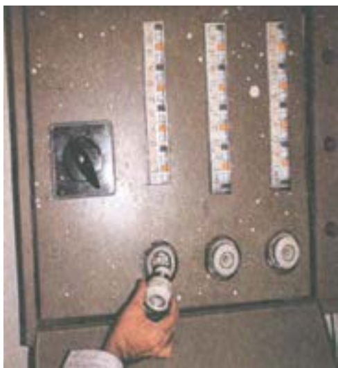
شکل ۶-۳- تابلوی برق توزیع داخلی، فیوزها و کلید قطع و وصل مربوطه.
