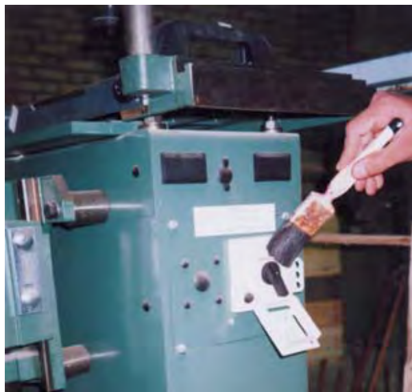
شکل ۱۰-۱۵- گردگیری و تمیز کردن کلید برق.
