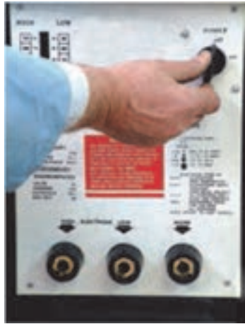
شکل ۵- نمایی از ترانسفورماتور
