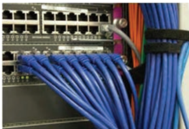
شکل ۲۵-۴- اتصال کابل‌ها به پیچ پانل
