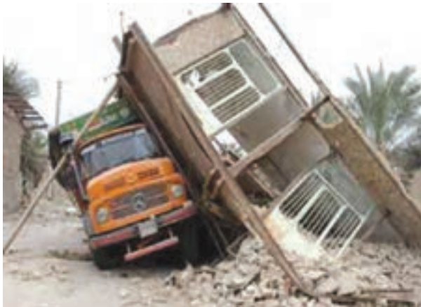
(د) ریزش دیوار در اثر زلزله
