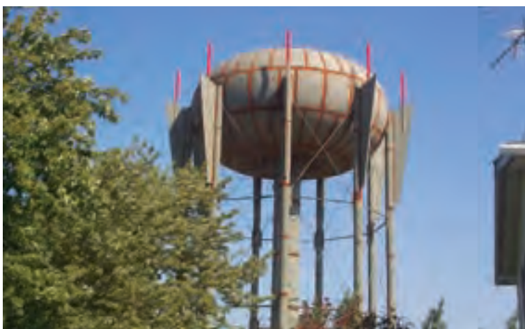
شکل ۷-۱۳- منبع آب از جنس فولاد کربنی در محل خط جوشها دچار زنگ زدگی شده است.
