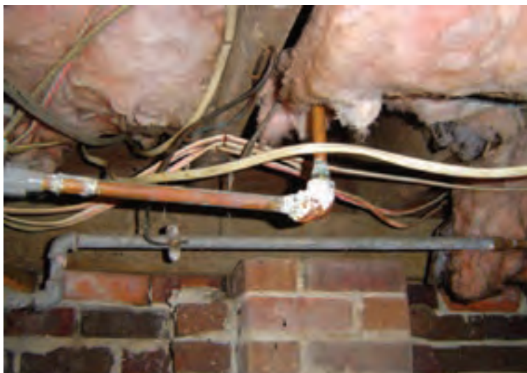
شکل ۷-۱۲- خوردگی زانوی فولادی گالوانیزه در اتصال با لوله مسی
