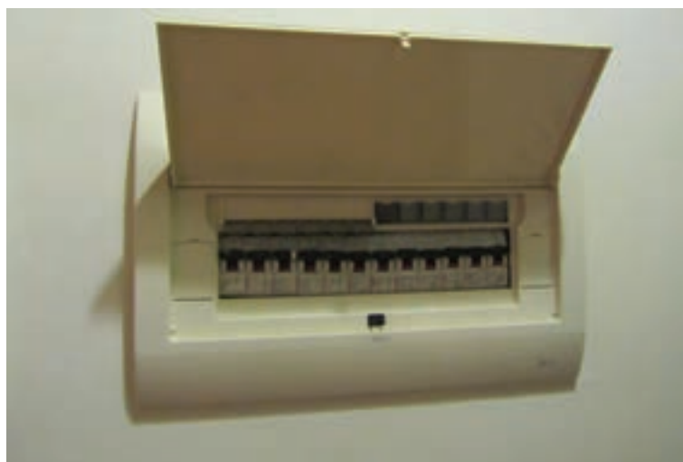
الف) تابلو برق تک فاز
