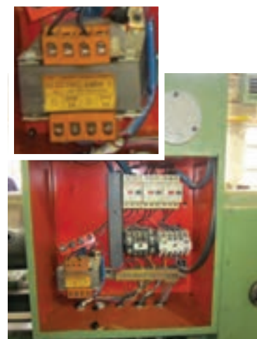
شکل ۴-۱۳ ترانسفورماتور در تابلوی برق دستگاه تراش.
