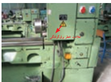
شکل ۱۵-۲ تابلوی برق دریل ستونی و یک نمونه دستگاه تراش.
