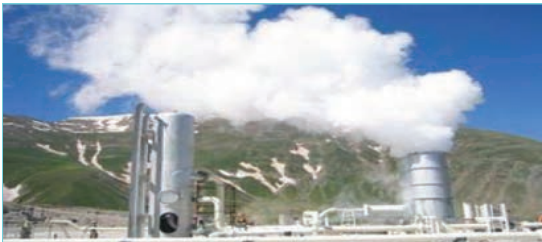
شکل ۲۴-۵- تأسیسات زمین گرمایی مشکین شهر
