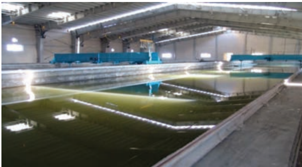
شکل ۴۵-۱- تصفیه خانه آب مشکین شهر
