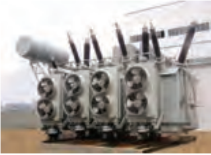
شکل (۳-۱) ترانسفورماتور خطوط انتقال
