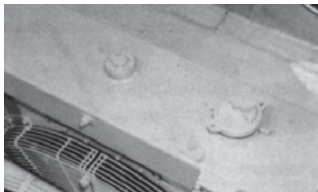
شکل ۹۷-۶ - بازديد سیستم خنک‌کننده از نظر نشتی
