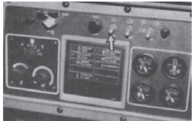
شکل ۳-۵- کلید آزمایش سیستم هشداردهنده
