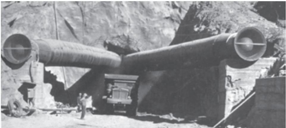
شکل ۳۷-۲- لوله‌های فلزی تهویه با اتصالات جوشکاری شده
