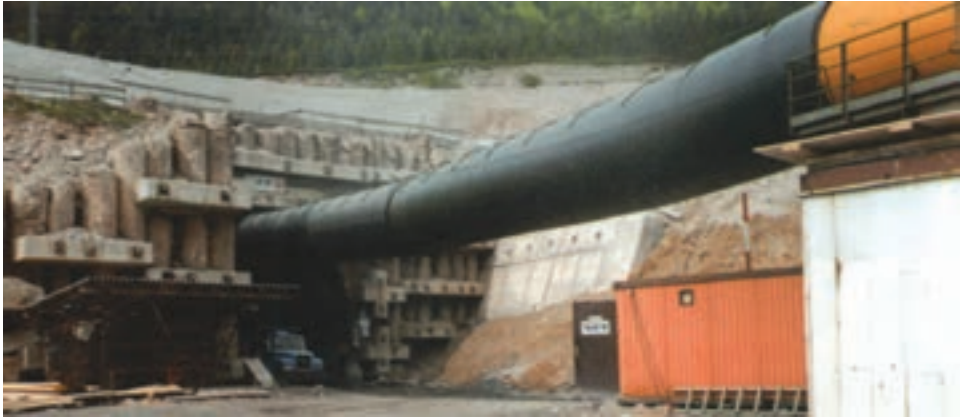
شکل ۳۶-۲- لوله‌های فلزی تهویه با اتصالات جوشکاری شده
