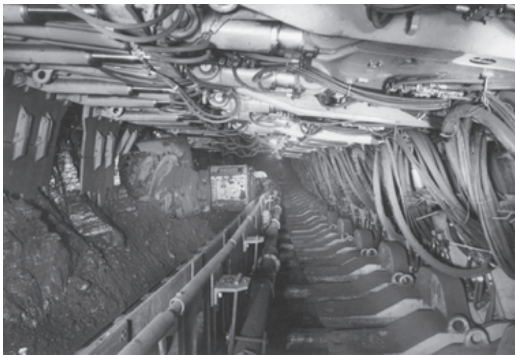
شکل ۹-۲۰- پایه قدرتی در کارگاه استخراج
