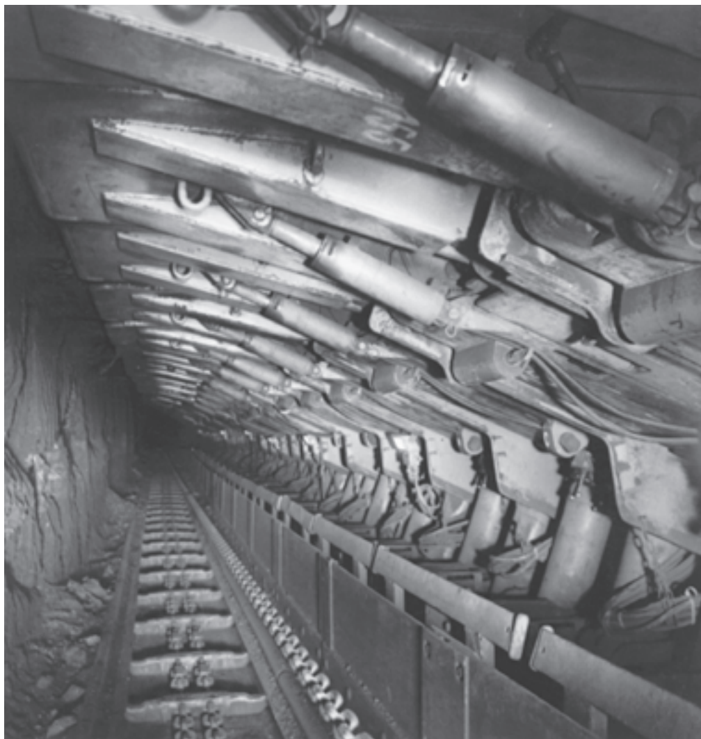
شکل ۹-۱۹- پایه قدرتی در کارگاه استخراج
