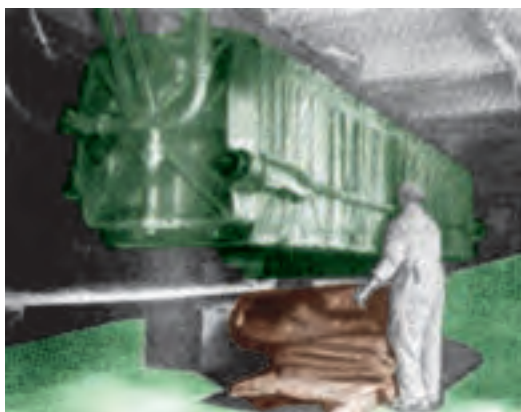
شکل ۲۴-۱- فیلتر پرس در حال تخلیه (به کیک‌های خارج شده از دستگاه دقت کنید)
