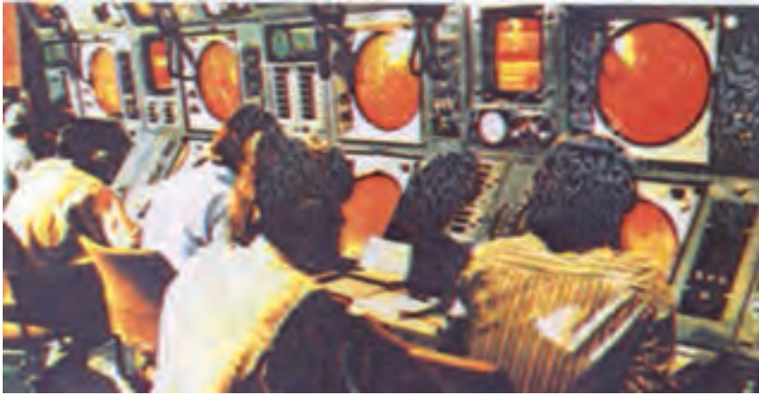
شکل ۹-۳- نمایی از اتاق رادار برج کنترل ترافیک فرودگاه
