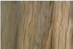
شکل ۱۴-۱- ترک‌های سطحی در تخته
