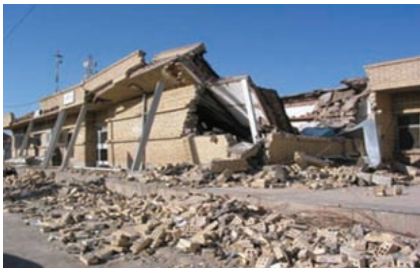
شکل ۱۲-۲- خسارات ناشی از زلزله در استان
