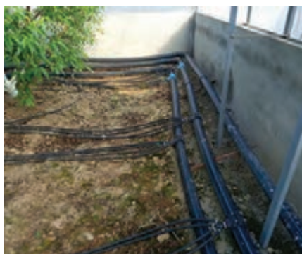
شکل ۳۳- سیستم لوله کشی آبیاری قطره‌ای در گلخانه
