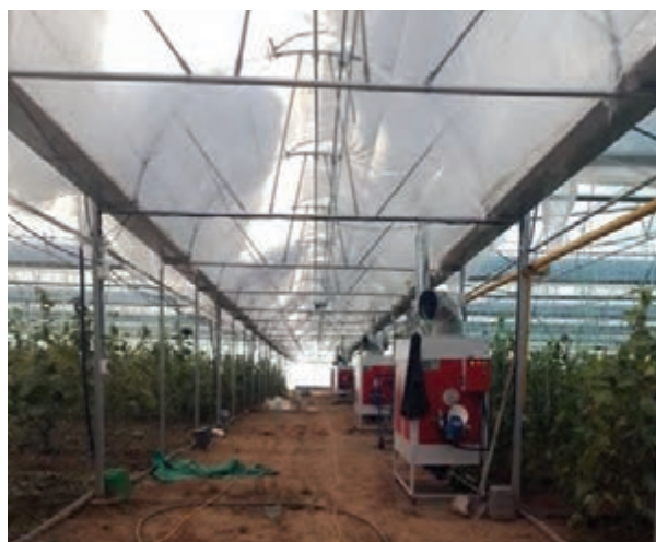
شکل ۵- نمایی از تأسیسات یک گلخانه
