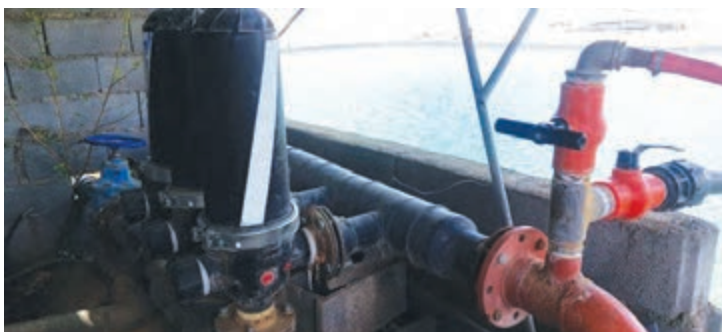
شکل ۳- سیستم موتورخانه در آبیاری قطره‌ای و فیلترهای دیسکی و لوله‌های اصلی آبیاری
