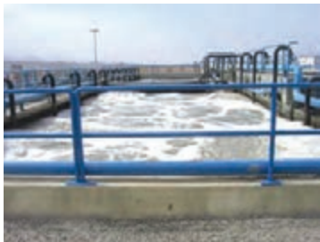
▲ شکل ۸-۲ تصفیه خانه آب
