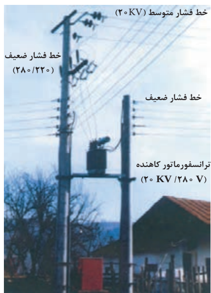
شکل ۲۷- خطوط فشاری متوسط و ضعیف هوایی برق
