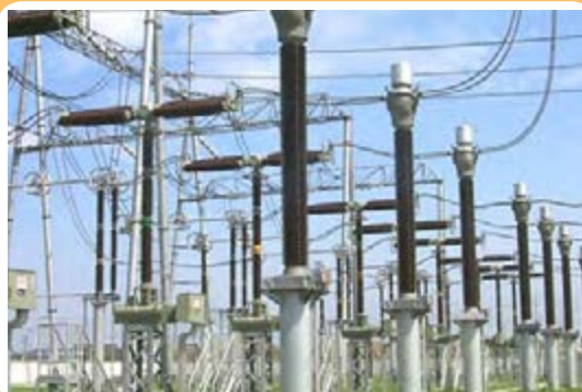
پست تقویت ولتاژ جریان برق
