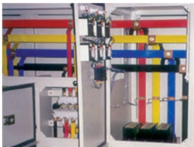
شکل ۳۸- شینه تابلو سه فاز
