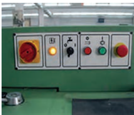
شکل ۸- جعبه کلیدهای فرمان
